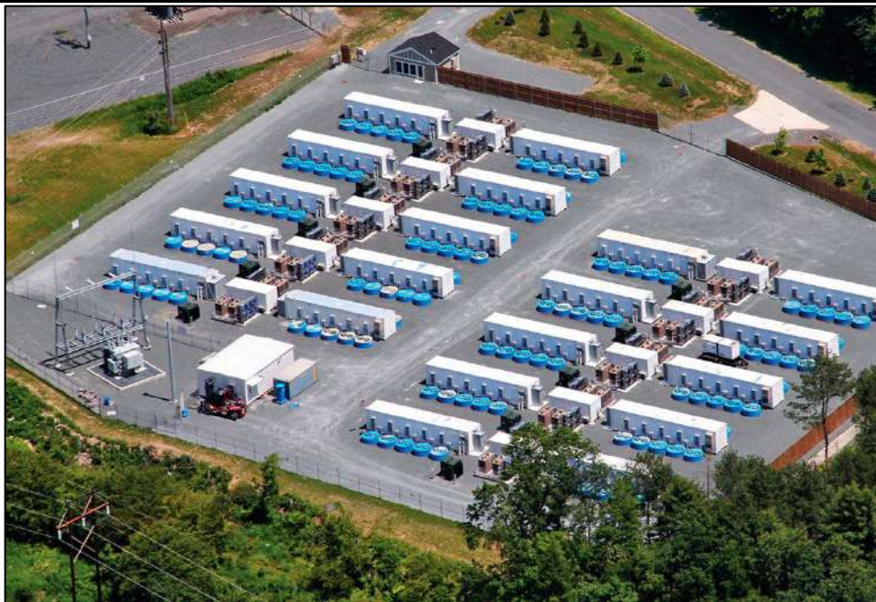
Рисунок 4 – Энергонакопительная станция, основанная на технологии маховика
