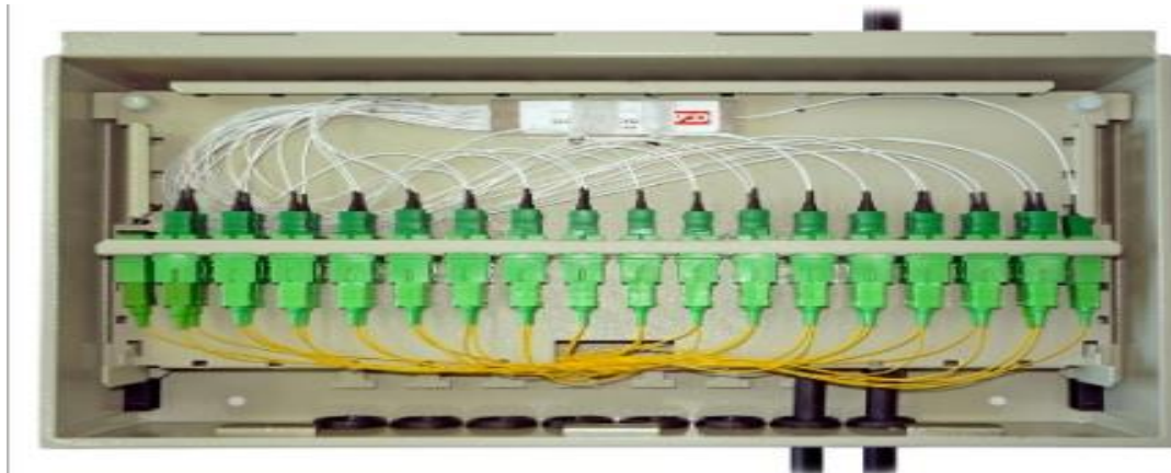
Рисунок 3 – Оптический распределительный шкаф.
