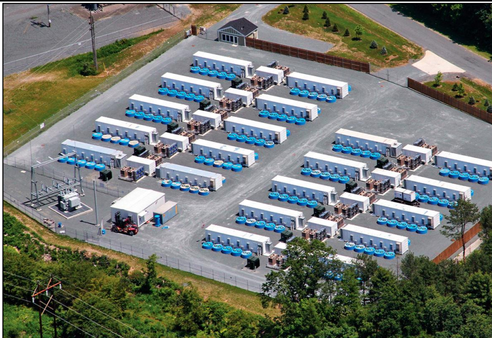
Рисунок 4 – Энергонакопительная станция, основанная на технологии маховика
